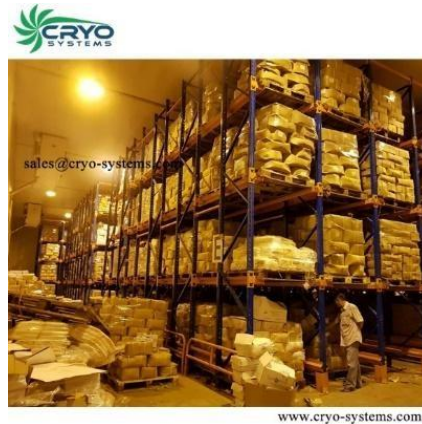
Figura 26 Almacenamiento refrigerado de papa https://cryo-systems.com/es/project/camara-frigorifica-para-patata/
